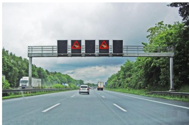
74 pav. Išmanių kelio ženklų įrengimas.
